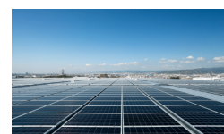
太陽光発電設備
