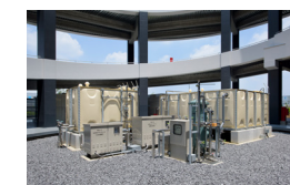
地下水供給設備
